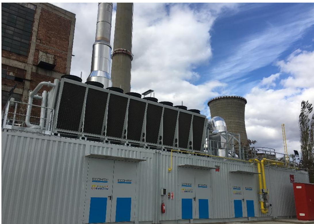
Imagini cu instalația de cogenerare
