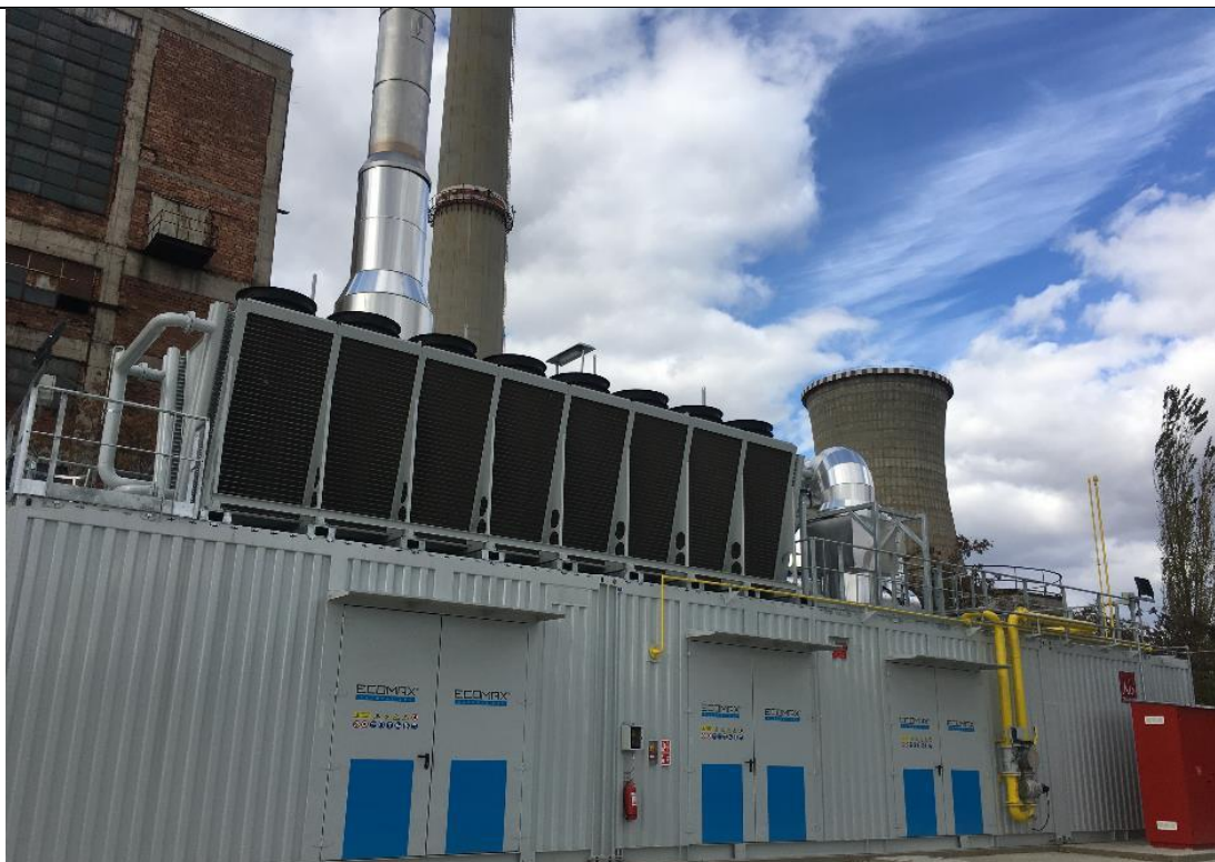
Imagini cu instalația de cogenerare
