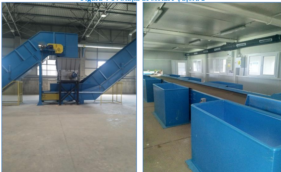
Figura 4-14 Stația de sortare Țuțora 2
