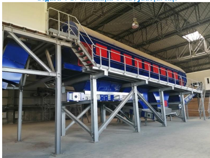
Figura 4-17 Instalația TMB, județul Iași
