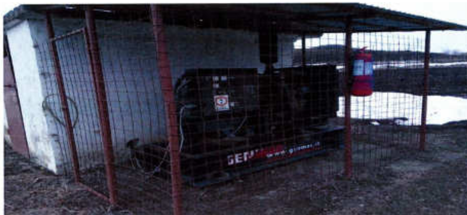
Amplasarea generatorului electric
