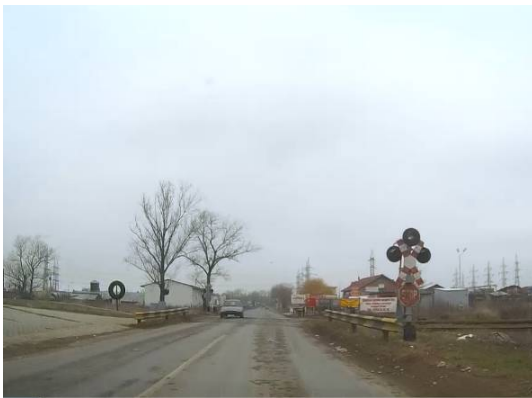
Figura 33: Exemplu de trecere la nivel cu calea ferată amenajată necorespunzător, Iași, Șoseaua Iași-Tomești
